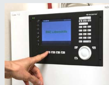
Die Steuerung der Brandmeldeanlage ist zentral und nutzerfreundlich.
