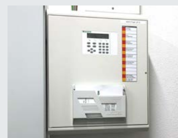
Mit der Einbruchmeldeanlage Securitel 500 wird die eingesetzte Technik integriert.
